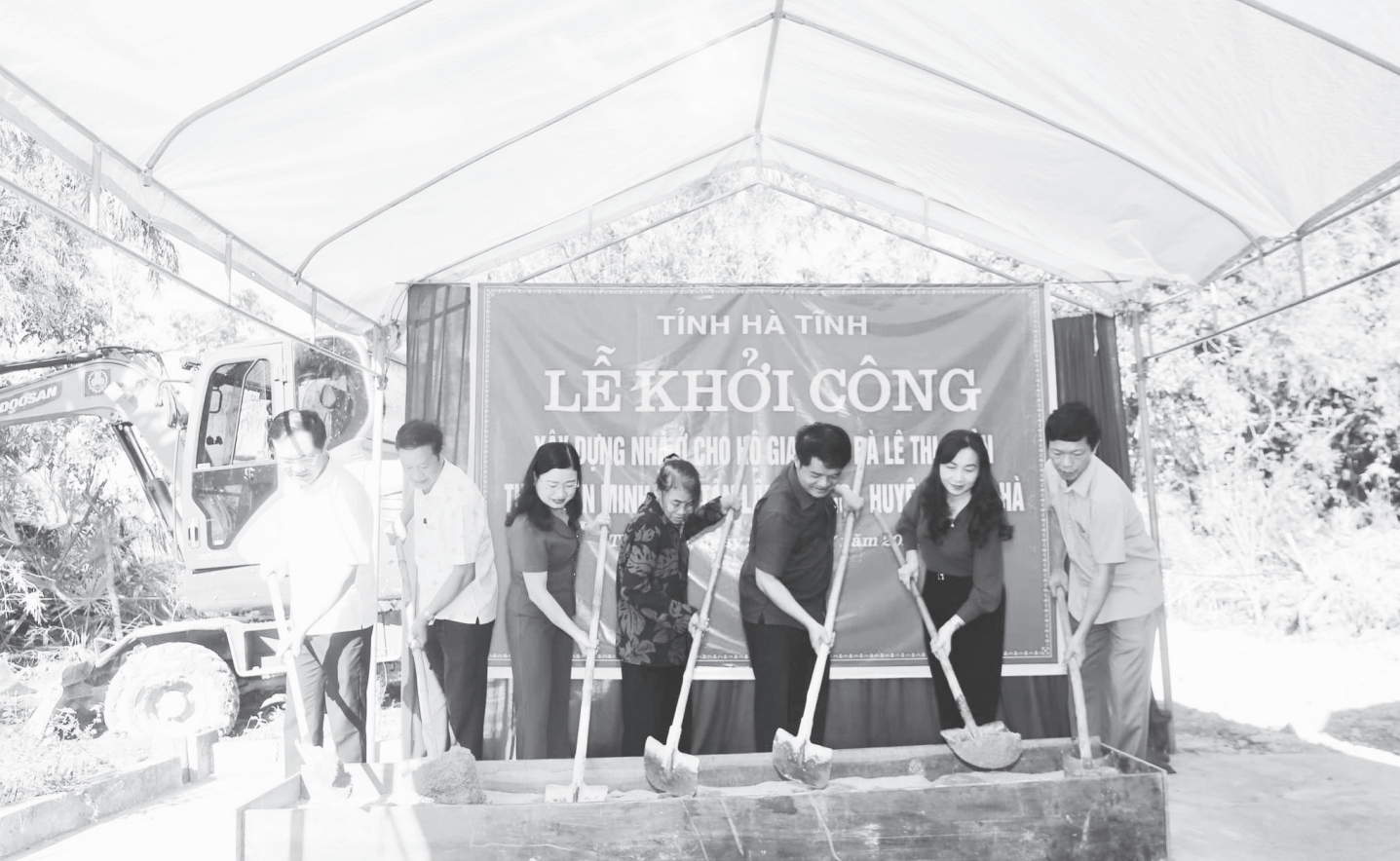
Các đồng chí lãnh đạo tỉnh, huyện dự khởi công nhà ở nguồn Quỹ cứu trợ tỉnh cho bà Lê Thị Xuân, xã Tân Lâm Hương, huyện Thạch Hà
