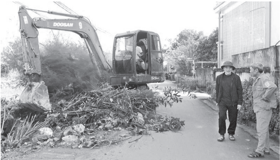
Người dân Tổ Dân Phố Đại Nghĩa, thị trấn Đức Thọ đồng thuận và phân khởi làm nương thoát nước ở khu dân cư - công trình chào mừng kỷ niệm 120 năm ngày sinh Đồng chí Trần Phú - Tổng Bí thư đầu tiên của Đảng (01/5/1904 - 01/5/2024)
