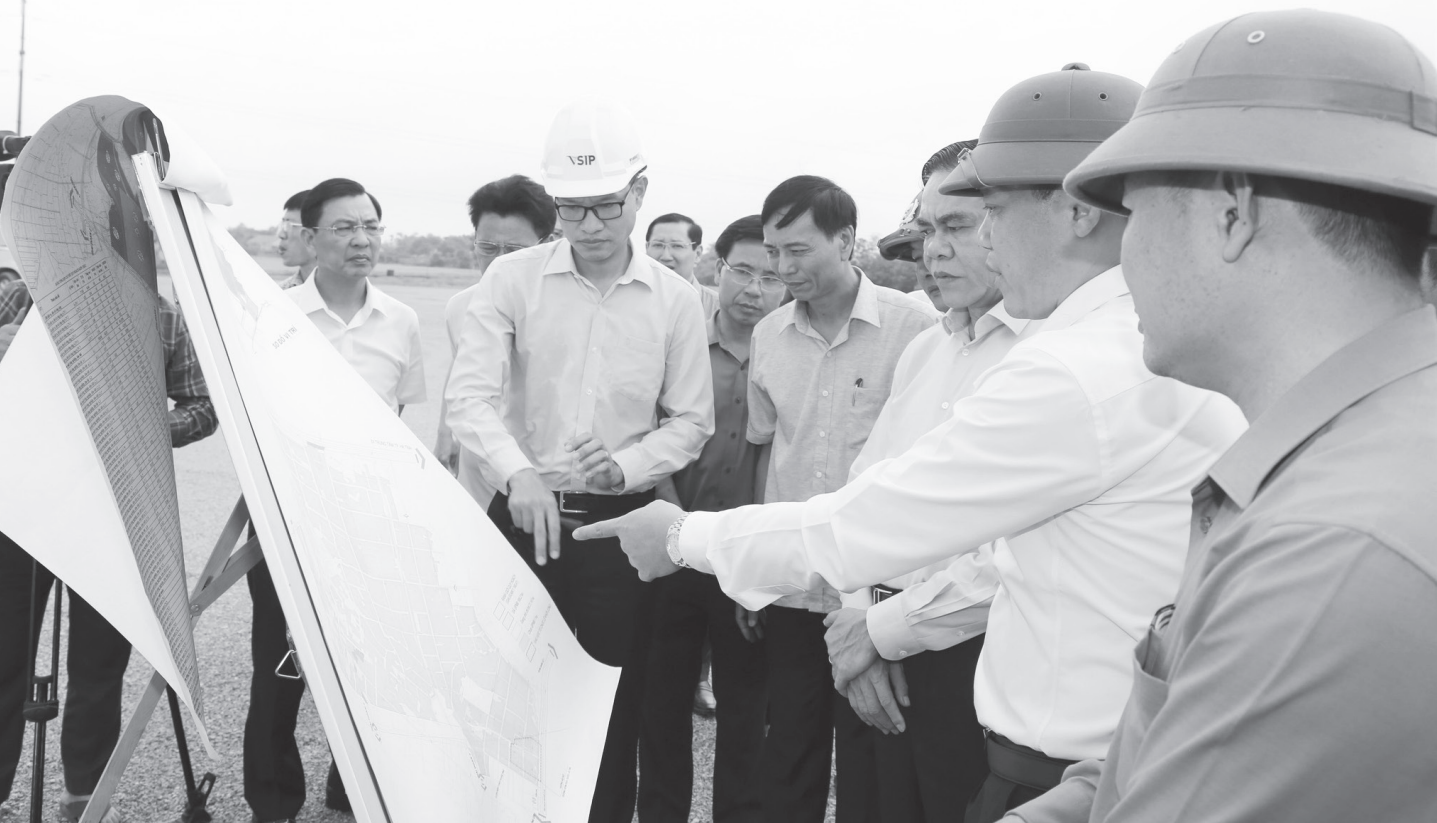
Lãnh đạo tỉnh và huyện kiểm tra công tác chuẩn bị khởi công Dự án xây dựng và kinh doanh kết cấu hạ tầng KCN Bắc Thạch Hà (giai đoạn 1). Ảnh: P.V
